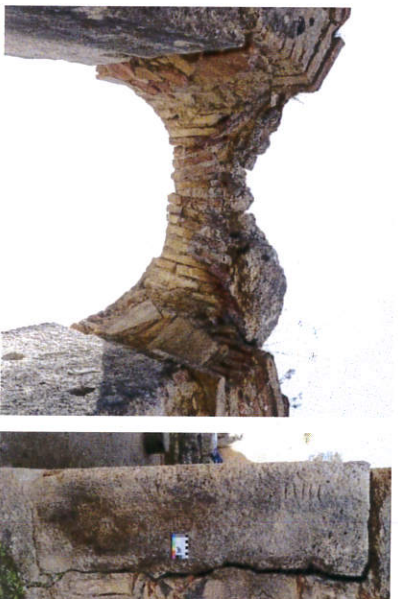
Εικόνα 28. Ετοιμορροπία, μετακίνηση δομικού στοιχείου (DAI Athen)
